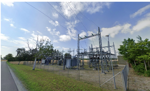
Figur 3 og 4. Eksisterende transformerstation set fra Sørupvej.
