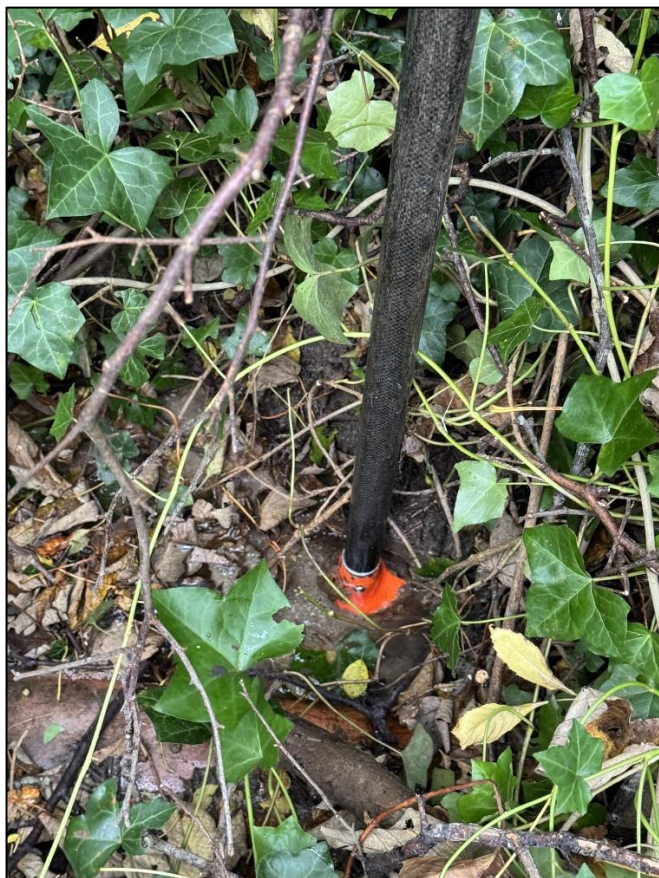
Figur 4: Rørudløb fra marken. Billedet viser afvandingssystem 4, hvor den orange fod markerer udløbet. I nederste venstre hjørne er udløbet fra afvandingssystem 1. Der forefindes ikke et billede af udløbet fra afvandingssystem 3.
