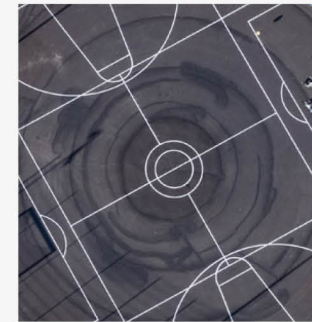
Asfalt med opstrikning.
