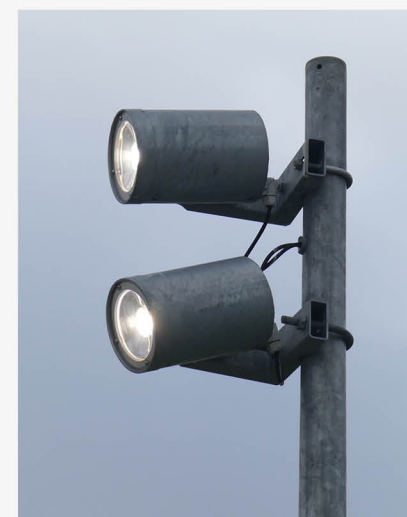
Belysningsmast med spots i galvaniseret stål.
